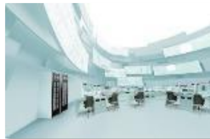
プラント制御システム
